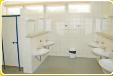
Sanitärgebäude Sanitary equipment Sanitair gebouw
